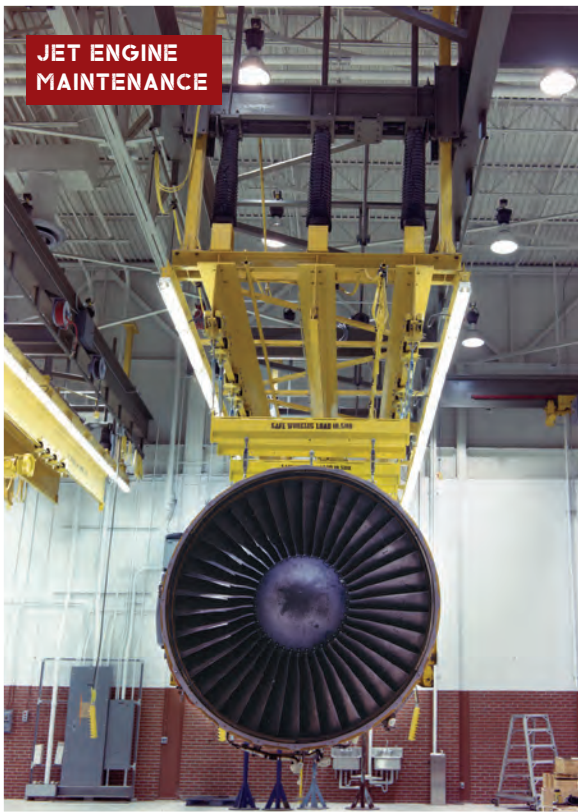
5 TON DOUBLE GIRDER CRANE
